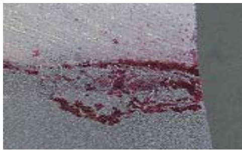
写真 4-2 溶接止端部拡大写真
